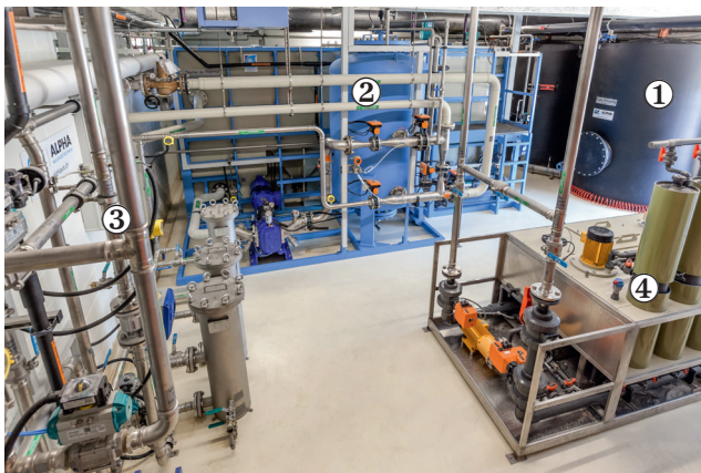
Figures 3 et 4 : ① Stripping CO 2 , ② Skid de décantation et filtre à sable, ③ Filtres, ④ Installation de stripping membranaire ammoniacale.
