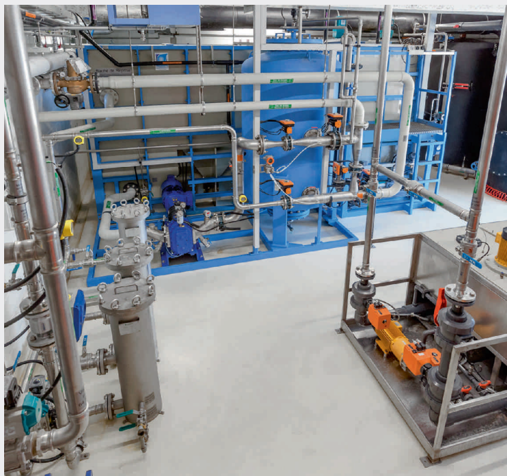
Fig. 3 Installation de traitement des centrats par stripping membranaire de la STEP d'Yverdon-les-Bains: Skid de décantation (à gauche), filtre à sable (au milieu) et installation de stripping membranaire de l'ammoniaque (à droite).
