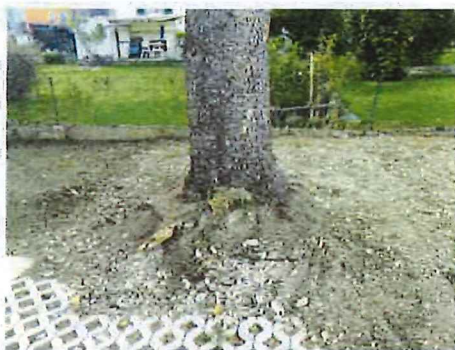
Destruction du sol et des racines aux abords du collet de l'arbre
