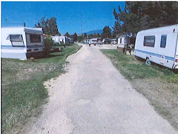
Visuel du chemin central dégradé. Raccord grossier en tout-venant.
