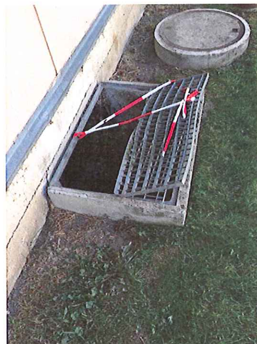
Pavillons de Pierre-de-Savoie Grille de saut-de-loup saccagée (10.2015)
