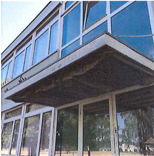
Pavillon du Pré-du-Canal Dégât suite à la mise à feu d'un canapé (07.2015)
